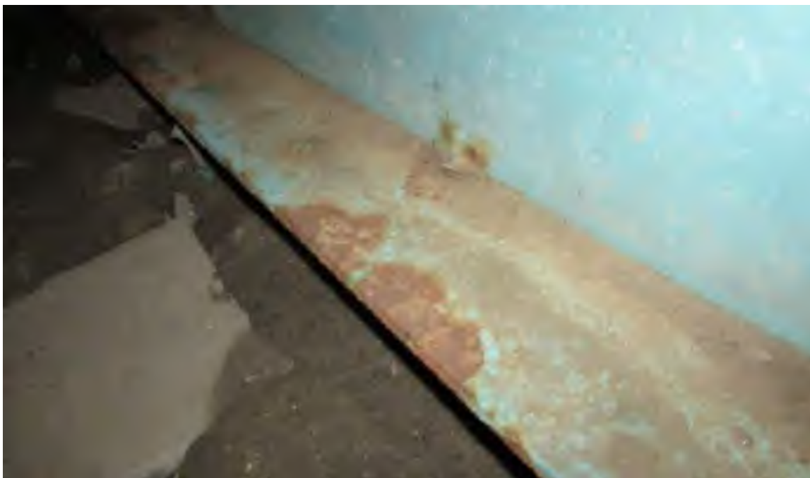
รูปที่ 10.3-2 สนิมเหล็กที่ปีกล่างของคานสะพานบริเวณใกล้ผิวดินที่มีการสะสมความชื้น
