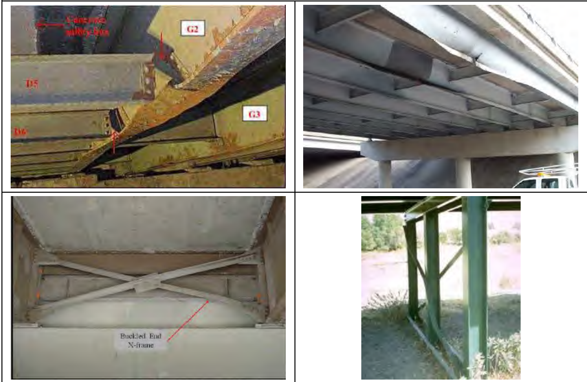
รูปที่ 3.3-4 การเสียรูปร่าง (Deformation) (ต่อ)
