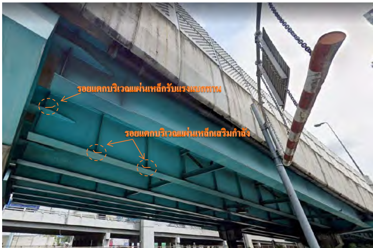
รูปที่ 10.3-3 ภาพจำลองรอยแตกบริเวณแผ่นเหล็กรับแรงเบกทานและแผ่นเหล็กเสริมกำลัง
