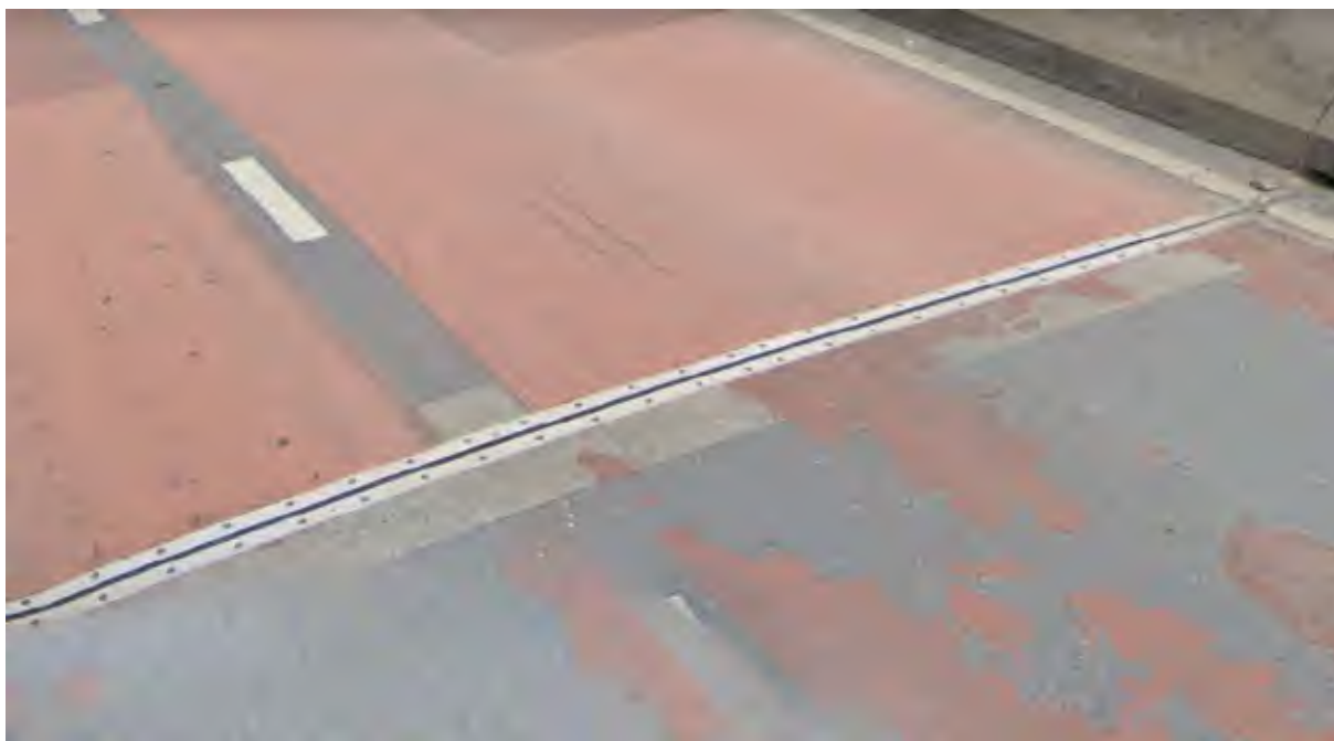
รูปที่ 10.2-7 รอยต่อพื้นสะพานแบบแผ่นเหล็ก
