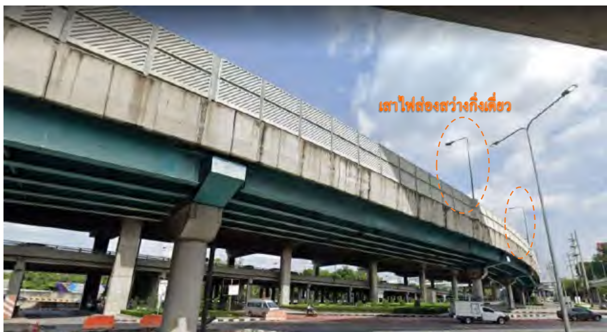
รูปที่ 10.2-11 ระบบไฟฟ้าแสงสว่าง
