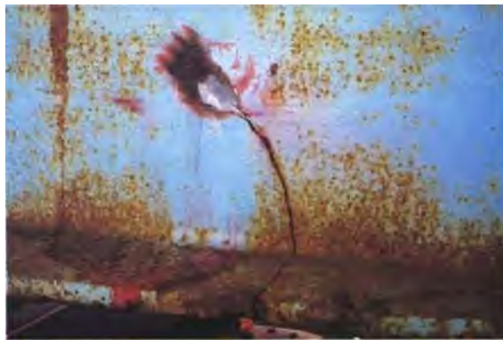
รูปที่ 3.3-2 ตัวอย่างรอยแตก (Cracking) (ต่อ)
