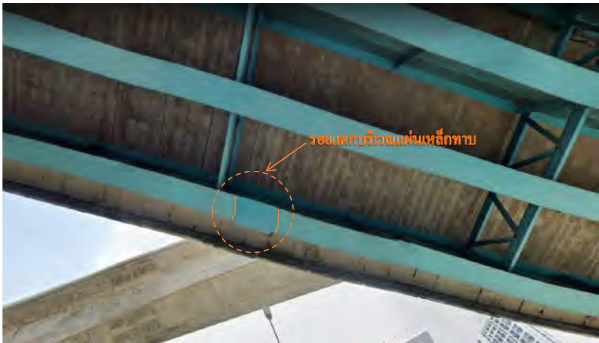
รูปที่ 10.3-6 ภาพจำลองรอยแตกบริเวณแผ่นเหล็กทาบ
