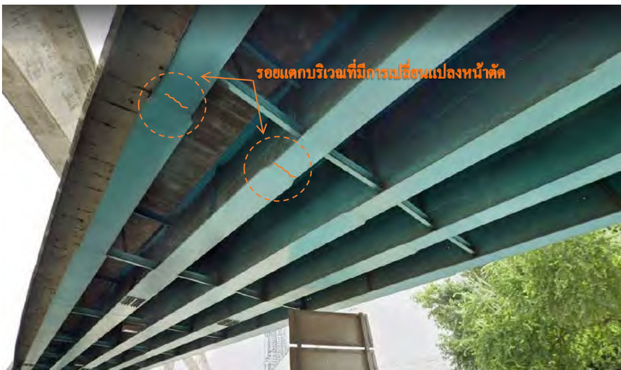
รูปที่ 10.3-5 ภาพจำลองรอยแตกบริเวณแผ่นปีกล่างบริเวณที่มีการเปลี่ยนแปลงหน้าตัด
