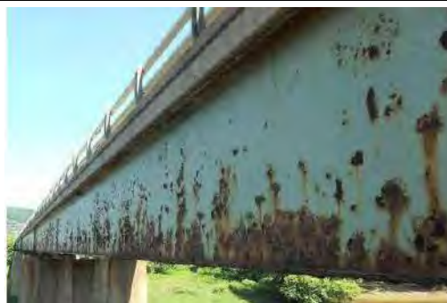
รูปที่ 3.3-1 ตัวอย่างการผุกร่อน (Corrosion) (ต่อ)
