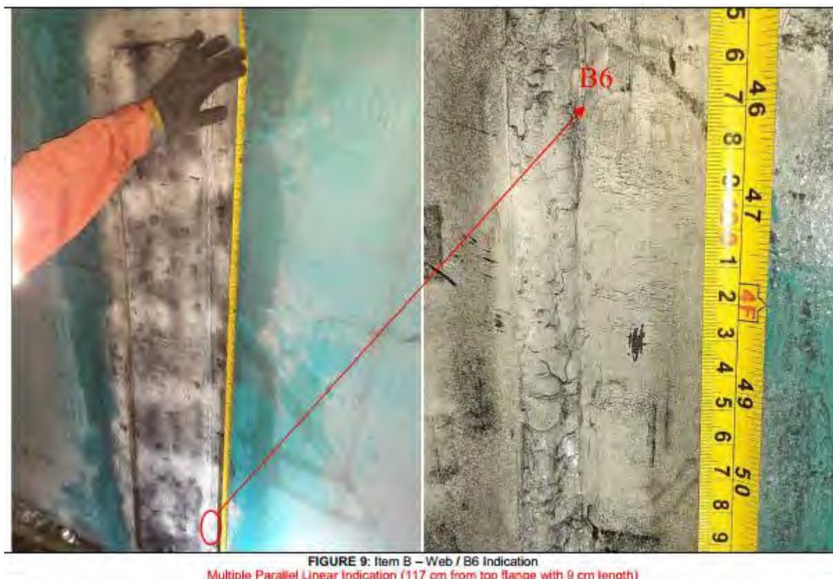
รูปที่ 4.2-8 ผลการตรวจสอบรอยเชื่อมที่ใช้ซ่อมบริเวณที่ฉีกขาดที่จุด B ด้วยวิธี Magnetic Particle (ภาพถ่ายที่เอวคาน ตำแหน่ง B6)
