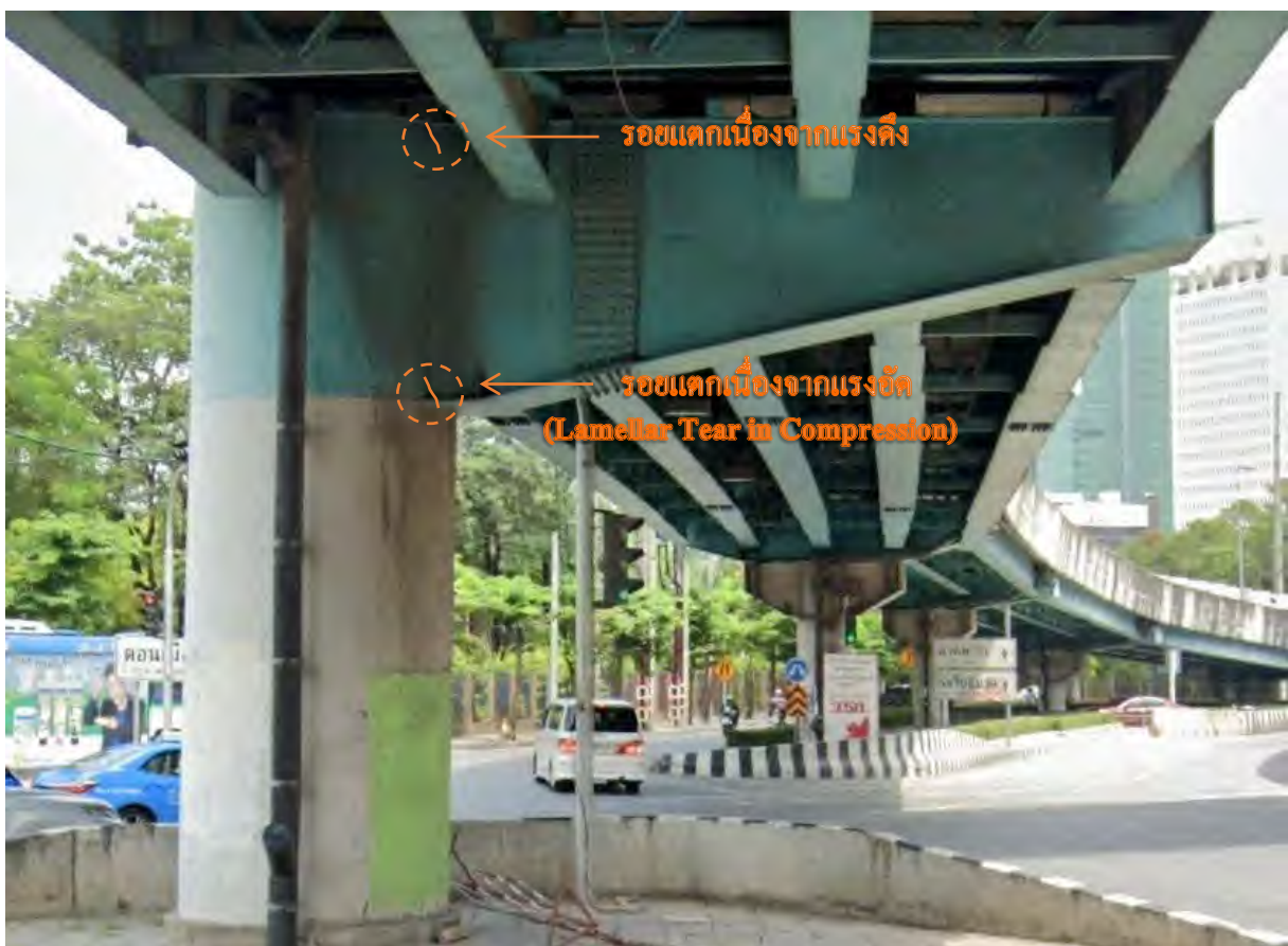
รูปที่ 10.3-7 ภาพจำลองรอยแตกบริเวณรอยต่อคานยื่นกับเสาสะพาน
